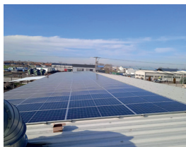
Juskufa Kft. | 64,4 kWp
