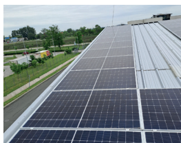
PI-METÁL Kft. | 170,97 kWp
