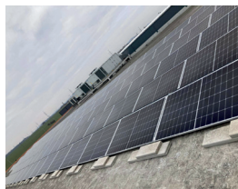
Piedl Kft. | 50,02 kWp
